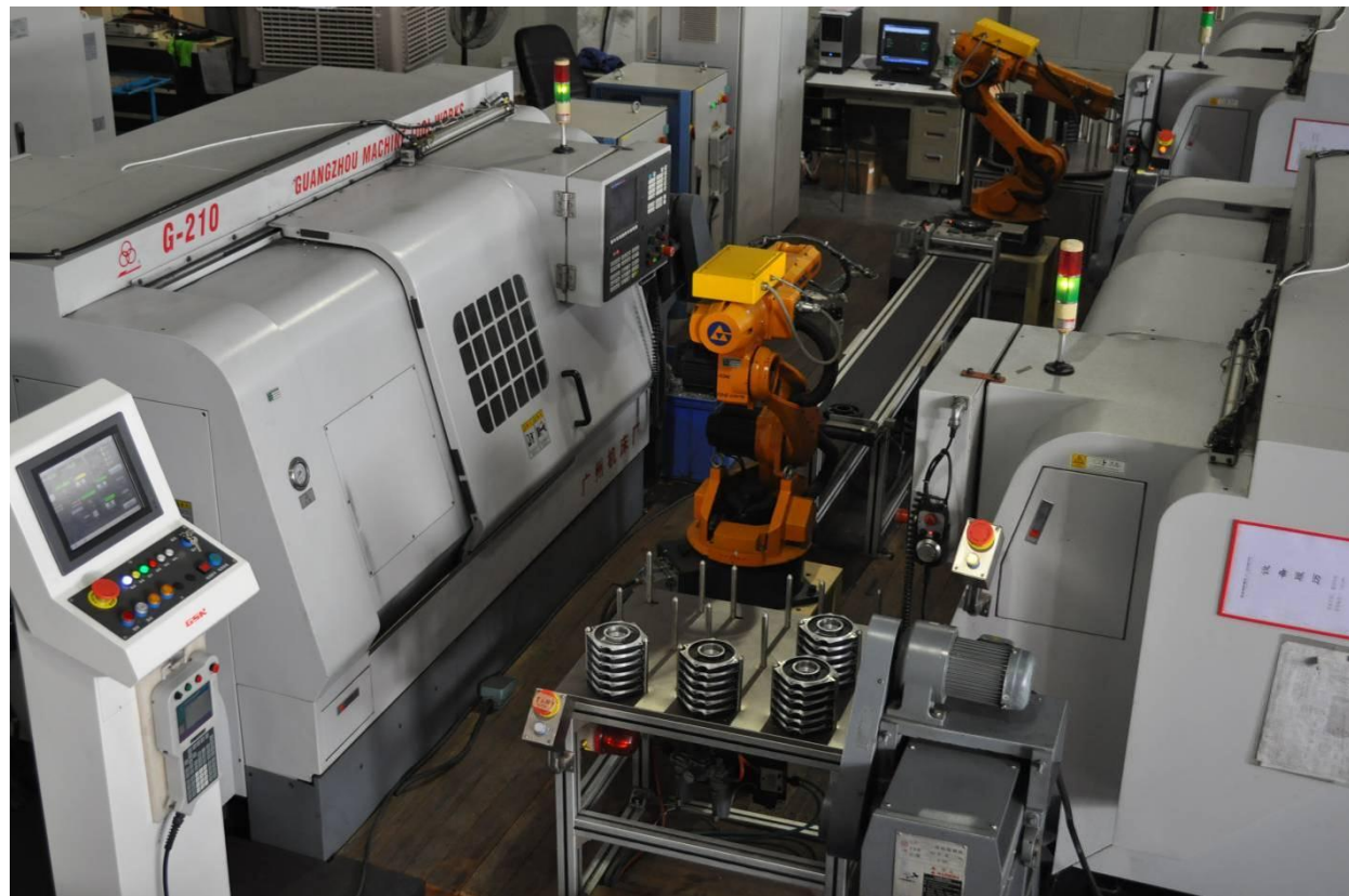
应用GPC1000A的电机后端盖生产线
