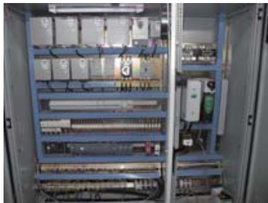
图 2 堆码机控制柜内部
