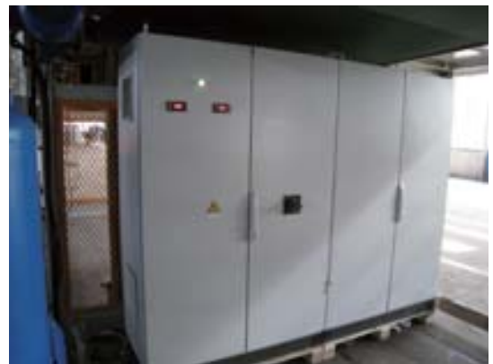
图 1 堆码机控制柜
