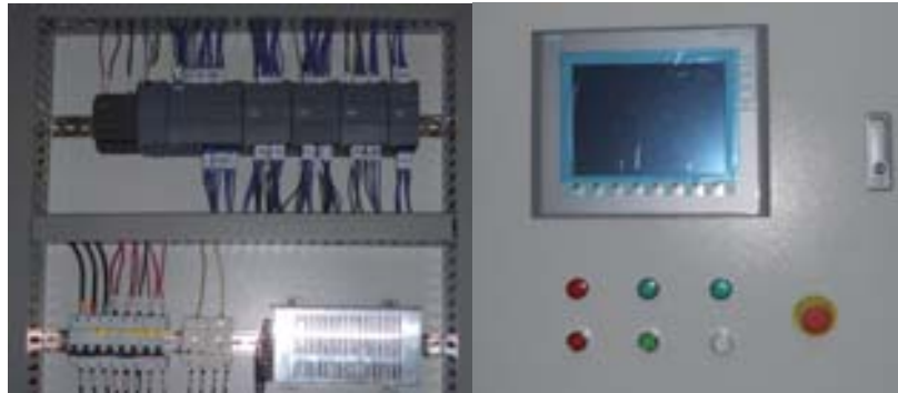
图 2 控制柜内部布置
