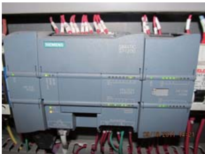
PLC 输入接线照片
